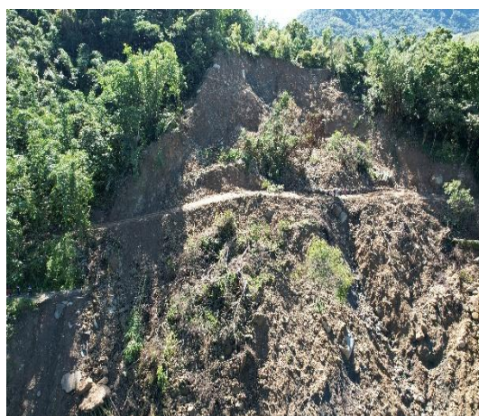
清水溝營林區「9林班線浸林道2.5K便道開設搶通作業」施工後
